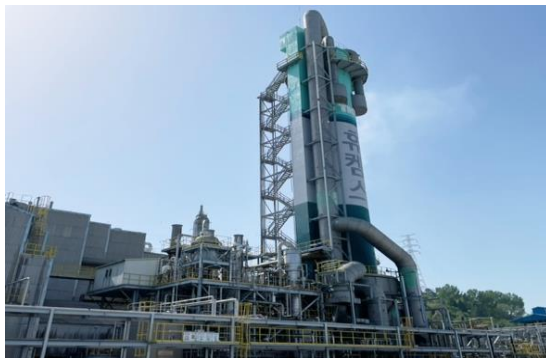
[ 초안 공장 미세먼지 제거 ]
